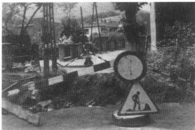
Mostek na ul. Grażyńskiego jest od kilkunastu dni w remoncie.
