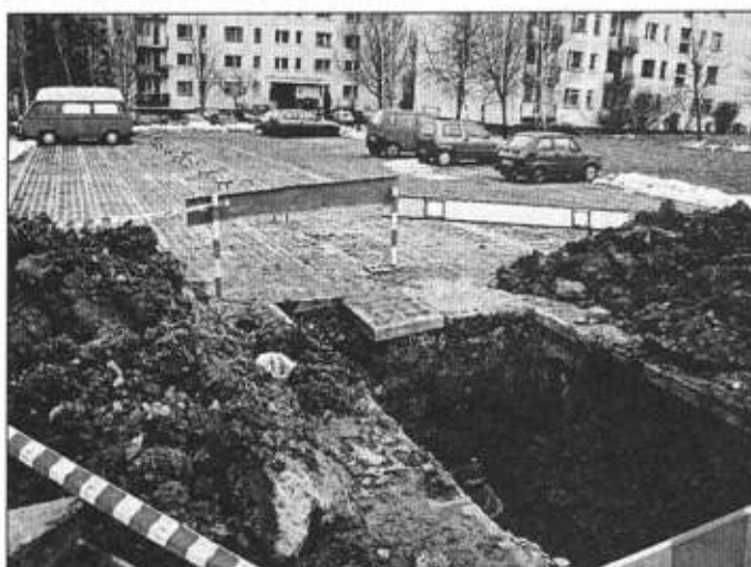
Tu pękła zasuwa.
