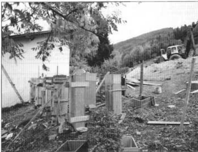
Stąd będzie pompowana woda.
