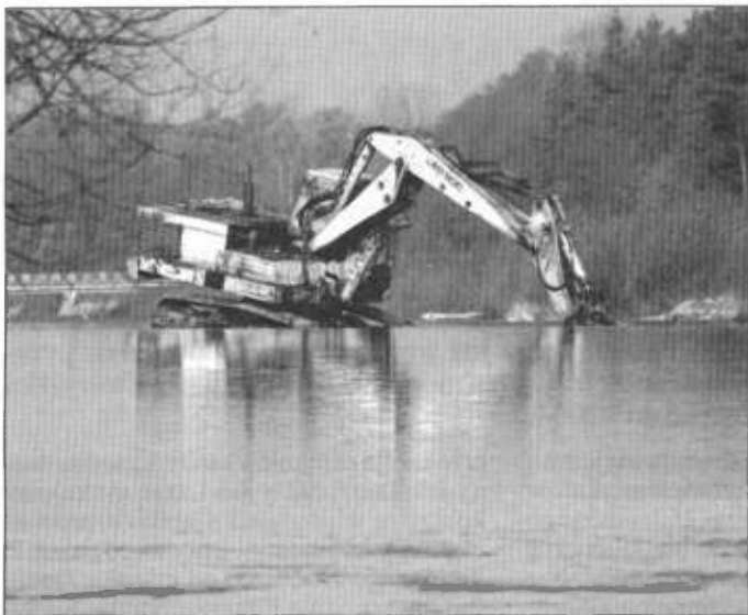
Koparka bez zabezpieczeń.
