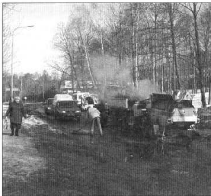
Po długiej, mroźnej zimie stan niektórych dróg jest fatalny. Głębokie dziury, pęknięcia są dotkliwe dla kierowców. Jeszcze nie stopniały śniegi, a drogowcy zaczęli latać dziury na ul. Sanatoryjnej. Fot. W. Suchta
