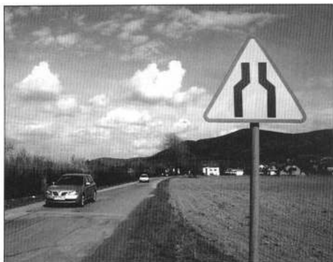
Powiatowa droga czekająca na remont.
