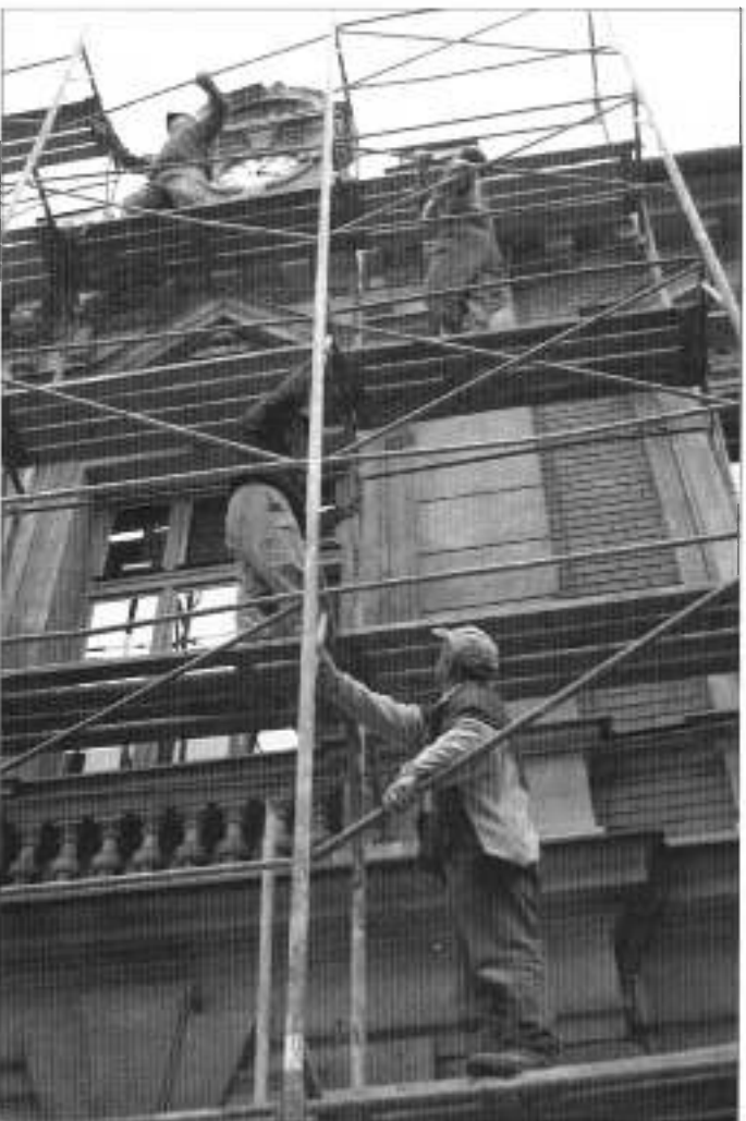
Trwa remont fragmentu budynku, w którym mieści się m.in. Miejska Biblioteka Publiczna i nasza redakcja. Z wieżyczki, na której znajduje się zegar, zaczęły spadać kawałki tynku i ściany. Doraźnego remontu, ale zgodnego z historycznym wyglądem podjęła się firma pana Klimurczyka. Koszt robót to 11.000 zł. Zostaną zakończone w połowie listopada. Fot. W. Suchta
