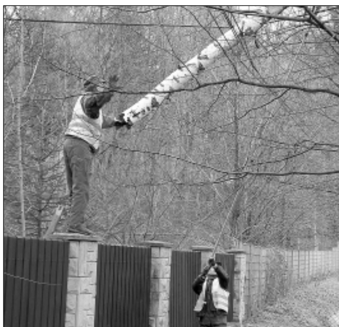
Elektrycy usuwają szkody po wichurze na ul. Belwederskiej. Brzoza zawisła tam na przewodach. Fot. K. Marciniuk
