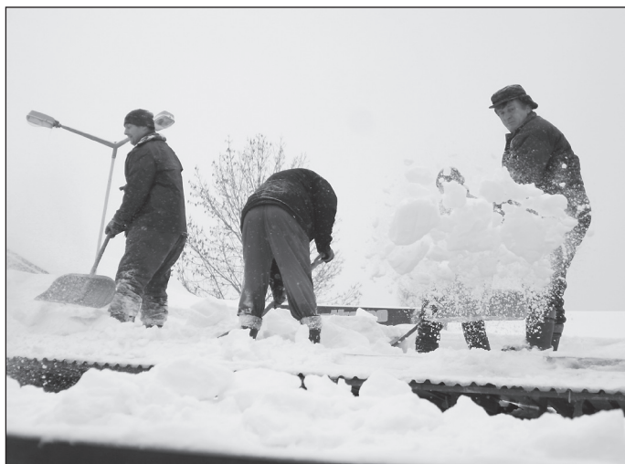
Przy odśnieżaniu dachów trzeba uważać...
