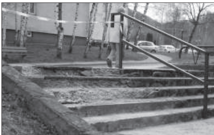
Sypią się schody przed pawilonem na os. Manhattan. Fot. W. Suchta
