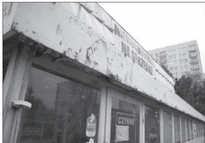
Nadzór budowlany nakazał rozebrać część blach. Fot. W. Suchta
