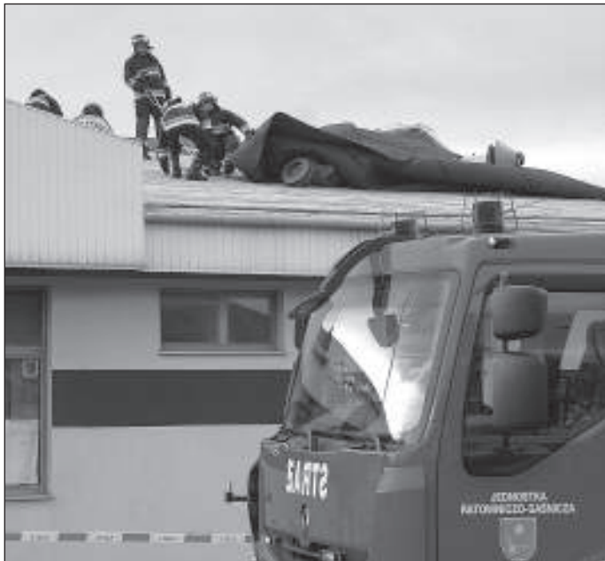
Wiatr zerwał pokrycie dachu na jednym z marketów. Interweniowała Straż Pożarna. Fot. W. Suchta
