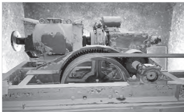
Silnik oraz przekładnia wprawiająca w ruch windę.
