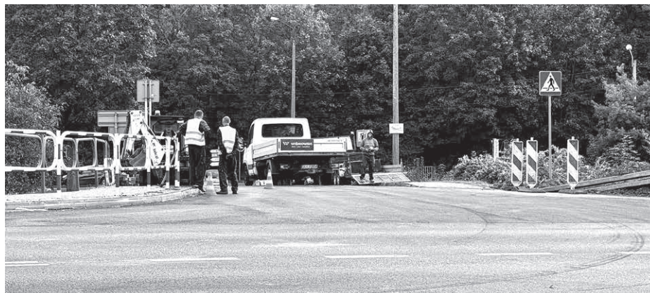
Rozpoczęły się prace związane z budową sygnalizacji świetlnej na skrzyżowaniu DW941 z ulicą Akacjową. Fot. Stowarzyszenie Bezpieczna Obwodnica Ustronia
