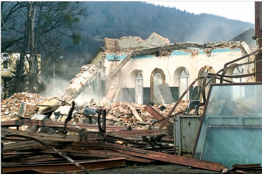
10 grudnia o godz. 14.16 runęła ostatnia, południowa ściana Salonu Kuracyjnego. Tym samym 156 lat historii obróciło się w niwecz. Fot. Muzeum Ustrońskie
